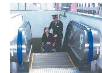
輪椅可使用的電扶梯 車いす対応エスカレーター
